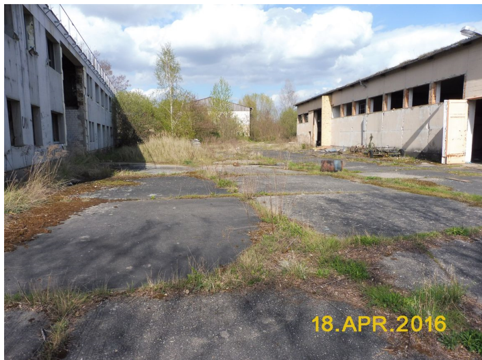
Bild 2: Großflächige Flächenversiegelungen. Im Laufe der Zeit lösen sich die Stoßfugen im Beton auf
