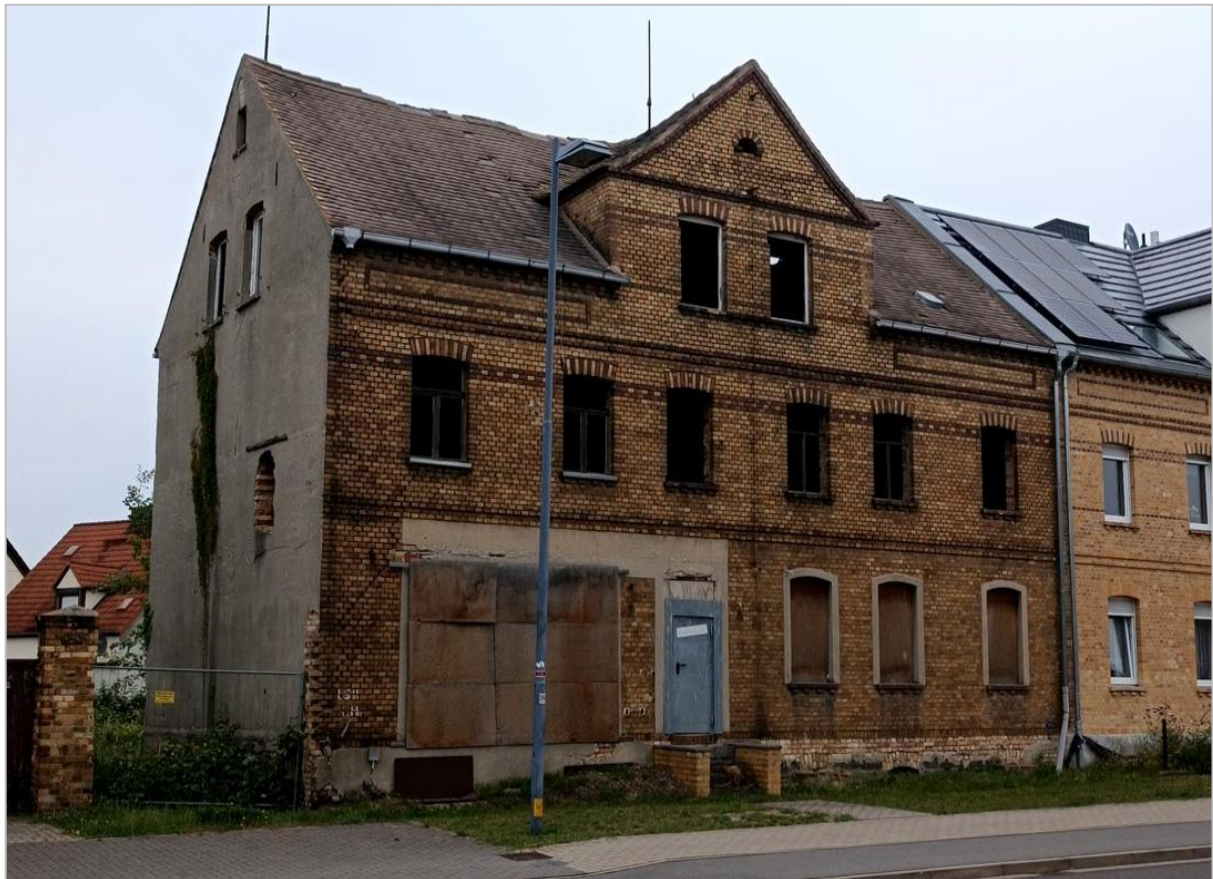
Abb. 17: Backsteingebäude von Verfall bedroht. Gegenüber Bitterfelder Straße 4
