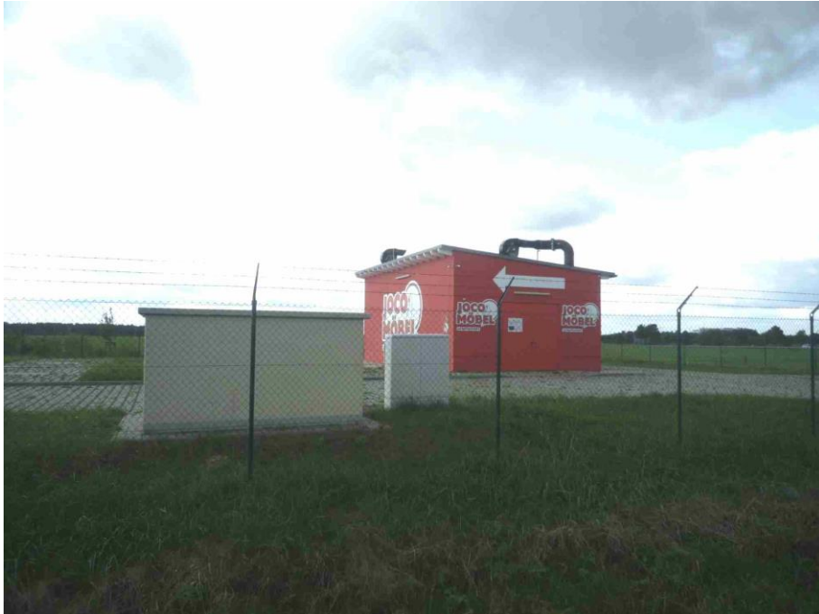
Abbildung 7: Umzäuntes Gelände mit Gebäuden für die Abwasserbeseitigung (Pumpstation) des Gewerbegebietes
